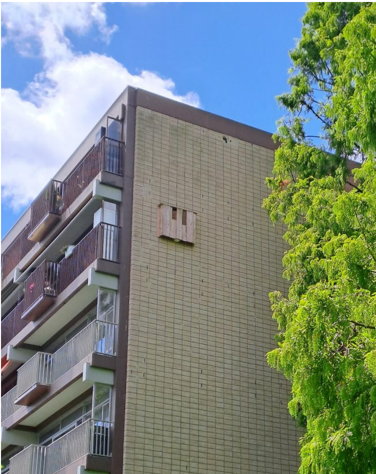
Figuur 3-1 Nest- en klankkast op één van de gevels bij locatie Garstkamp, Amsterdam-Zuidoost. Rechtsboven de kast is een gat in de gevel te zien. Ook is het linker insectenhotel deels beschadigd.
