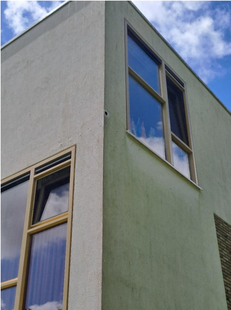
Figuur 3-4 Geveldraden op de gevels bij locatie Walstro, Castricum. Boven de bevestigingsogen is een gat in de gevel te zien.
